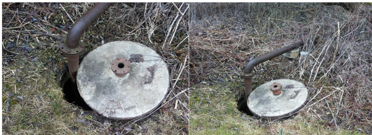
2.2.53 pav. Nuotekų išleistuvas šalia Neries upės ties Lapėmis
